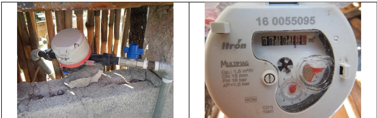
Figura 15. Medidor 160055095, clase C. Toma y detalle de medidor con número de serie. Con VAF. Comunidad Aposentos. Lectura del medidor: 101.38 m 3 .
