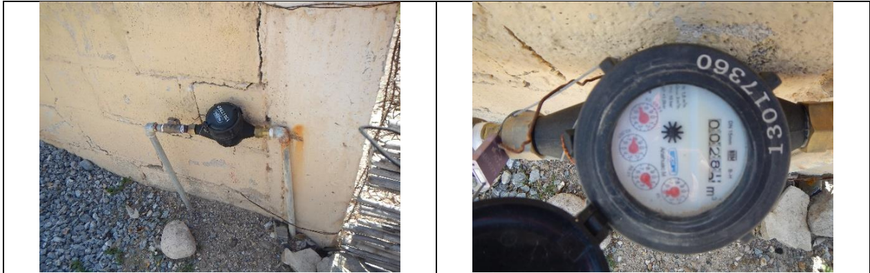
Figura 4. Medidor 13017360, clase B. Toma y detalle de medidor con número de serie. Con VAF. Localidad Peñamiller. Lectura del medidor: 281 m 3 . Medidor aparentemente no nuevo, se verificará porque no corresponde a las marcas y números de serie adquiridos en el marco del programa (PMCOOA).
