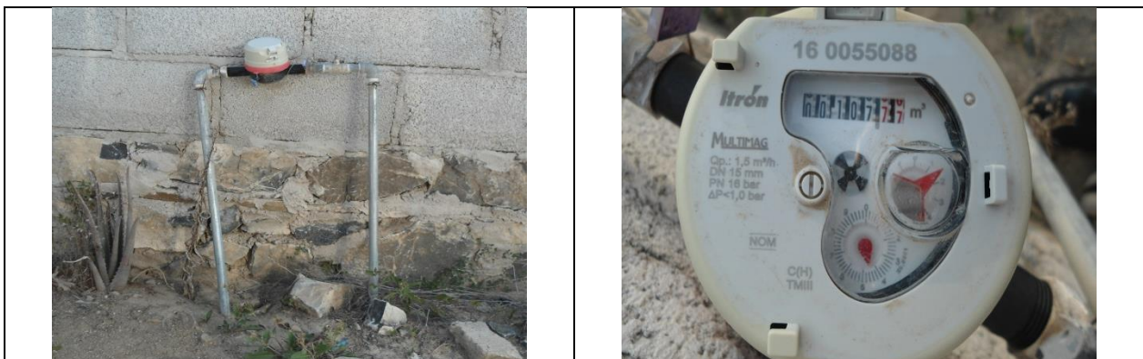
Figura 21. Medidor 160055088, clase C. Toma y detalle de medidor con número de serie. Sin VAF. Comunidad Las Enramadas. Lectura del medidor: 107.77 m 3 .
