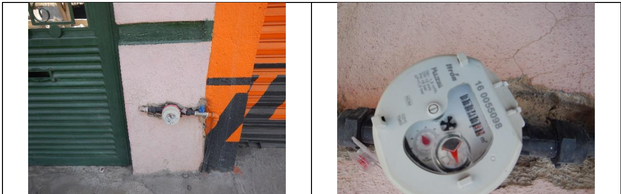
Figura 8. Medidor 160055098, clase C. Toma y detalle de medidor con número de serie. Con VAF. Localidad Peñamiller. Lectura del medidor: 10.92 m 3 .
