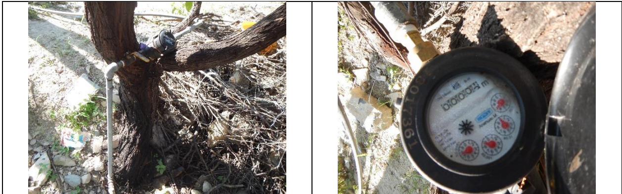
Figura 14. Medidor 13017361, clase B. Toma y detalle de medidor con número de serie. Sin VAF. Comunidad Aposentos. Lectura del medidor: 2 m 3 . Medidor aparentemente nuevo (por el consumo registrado), se verificará porque no corresponde a las marcas y números de serie adquiridos en el marco del programa (PMCOOA).
