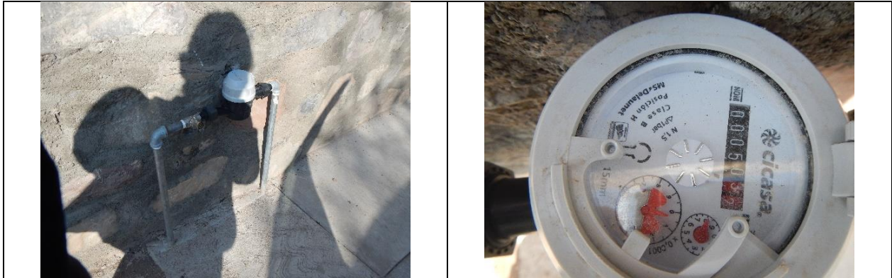
Figura 10. Medidor 16233522, clase B. Toma y detalle de carátula de medidor. Con VAF. Comunidad El Álamo. Lectura del medidor: 50.32 m 3 .
