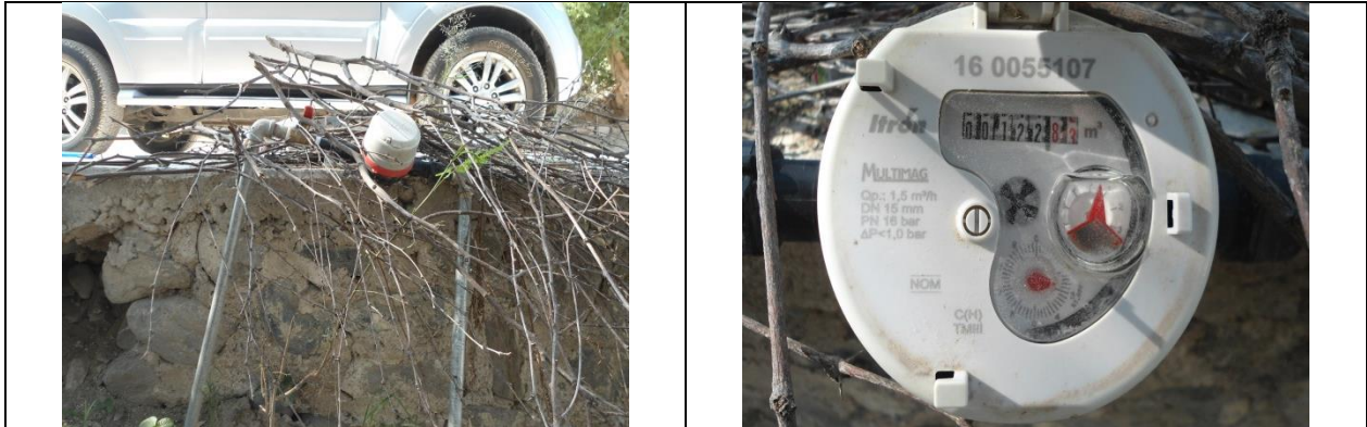
Figura 22. Medidor 160055107, clase C. Toma y detalle de medidor con número de serie. Sin VAF. Comunidad Las Enramadas. Lectura del medidor: 122.83 m 3 .
