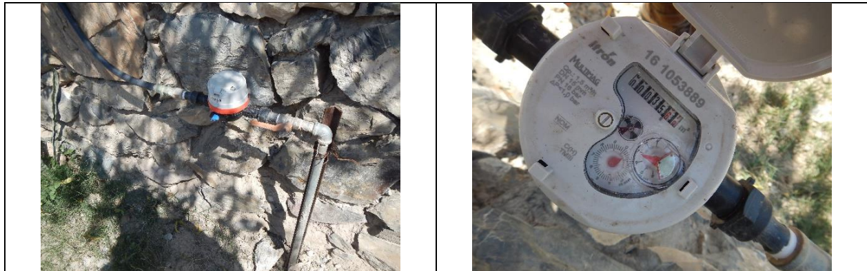
Figura 3. Medidor 161053889, clase C. Toma y detalle de medidor con número de serie. Sin VAF. Localidad Peñamiller. Lectura del medidor: 35.68 m 3 .
