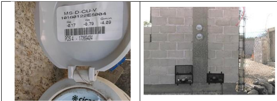
Figura 10. Medidor CICASA, MS Delaunet 17269424, clase B, sin VAF. Detalles de medidor con número de serie. Colonia Lomas de Guadalupe, municipio de Tequisquiapan. Lectura del medidor: 0.384 m 3 . Predio en construcción.
