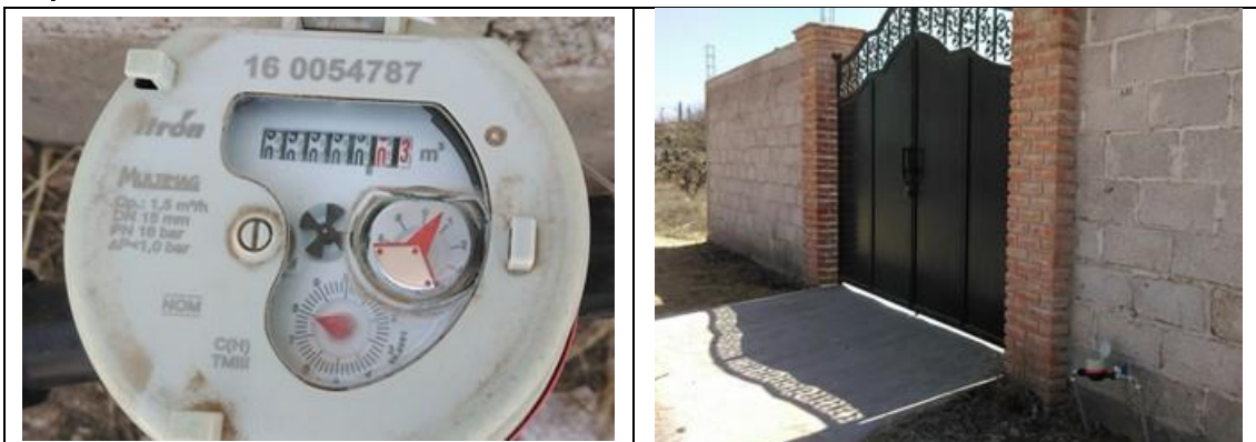
Figura 29. Medidor Itrón, Multimag 160054787, clase C, con VAF . Detalles de medidor con número de serie. Comunidad La Tortuga, municipio de Tequisquiapan. Lectura del medidor: 0.030 m 3 . El predio está deshabitado. La marca del medidor debe ser Itrón y no Itrón Actaris, por lo que se debe corregir en el padrón de usuarios.
