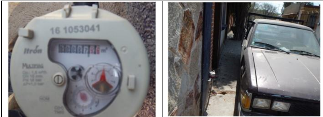
Figura 28. Medidor Itrón, Multimag 161053041, clase C, con VAF . Detalles de medidor con número de serie. Comunidad La Laja, municipio de Tequisquiapan. Lectura del medidor: 87.96 m 3 . El medidor no tiene tapa.
