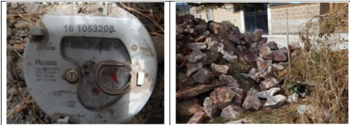
Figura 13. Medidor Itrón, Multimag 161053208, clase C, con VAF. Detalles de medidor con número de serie. Colonia Geoplazas, municipio de Tequisquiapan. Lectura del medidor: 132.60 m 3 . El medidor está instalado en el interior del predio y casi cubierto el cuadro por tierra.
