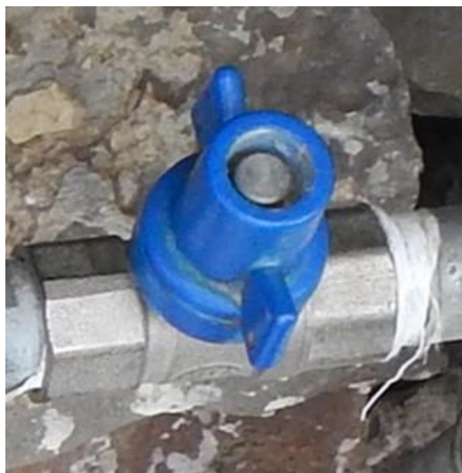
Ilustración 10. Válvulas antifraude instaladas en varias de las tomas con instalación o sustitución de medidores.
