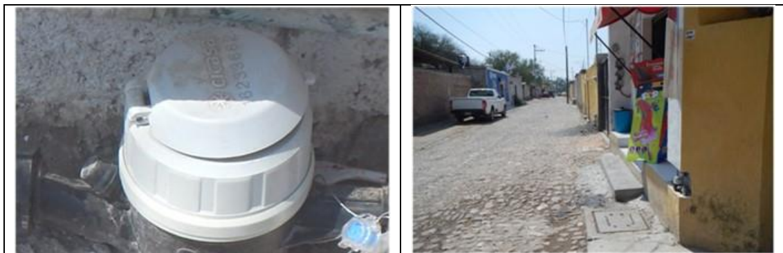
Figura 20. Medidor CICASA, MS Delaunet 16233662, clase B, con VAF. Detalles de medidor con número de serie. Comunidad La Fuente, municipio de Tequisquiapan. Lectura del medidor: 114.70 m 3 .
