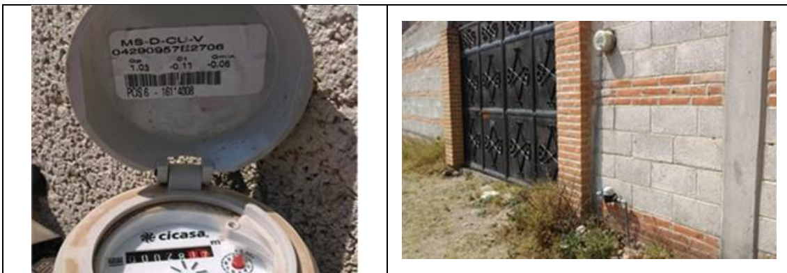
Figura 5. Medidor CICASA, MS Delaunet 16114008, clase B, con VAF. Detalles de medidor con número de serie. Colonia Ampliación Adolfo López Mateos, municipio de Tequisquiapan. Lectura del medidor: 28.171 m 3 . Existe goteo en la unión del niple con la VAF.
