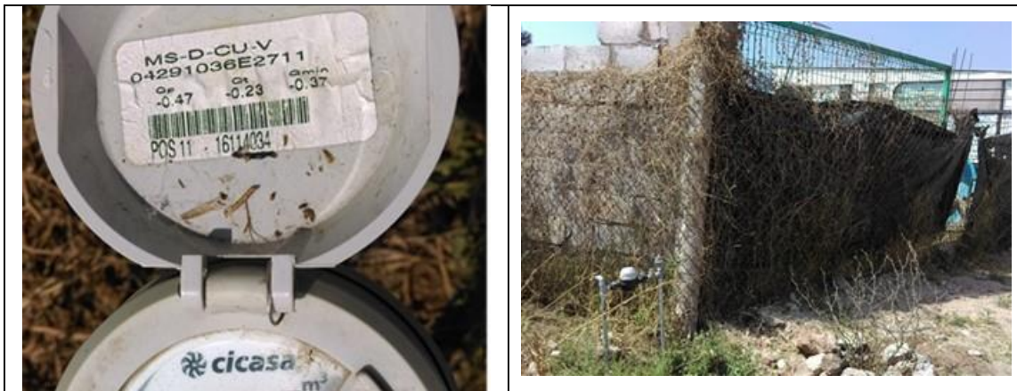
Figura 7. Medidor CICASA, MS Delaunet 16114034, clase B, con VAF. Detalles de medidor con número de serie. Colonia Cerrito San José, municipio de Tequisquiapan. Lectura del medidor: 2.633 m 3 . No hay construcción, solo el puro lote. Tiene válvula de expulsión de aire.
