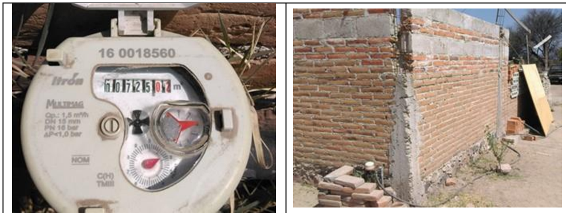
Figura 30. Medidor Itrón, Multimag 160018560 clase C, sin VAF. Detalles de medidor con número de serie. Comunidad San Nicolás, municipio de Tequisquiapan. Lectura del medidor: 725.020 m 3 . El material del conducto que conecta el cuadro con la instalación interior es de plástico (manguera). La marca del medidor debe ser Itrón y no Itrón Actaris, por lo que se debe corregir en el padrón de usuarios.
