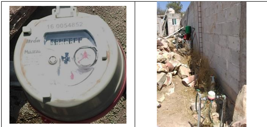
Figura 11. Medidor Itrón, Multimag 160054852, clase C, sin VAF. Detalles de medidor con número de serie. Colonia Los Arquitos, municipio de Tequisquiapan. Lectura del medidor: 118.100 m 3 . El cuadro está sujeto con varillas. Al momento de la visita hay una fuga en la unión de la válvula de paso y el medidor.
