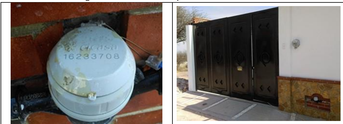
Figura 6. Medidor CICASA, MS Delaunet 16233708, clase B, sin VAF. Detalles de medidor con número de serie. Colonia Ampliación Santa Fe, municipio de Tequisquiapan. Lectura del medidor: 37.484 m 3 . La casa está deshabitada.
