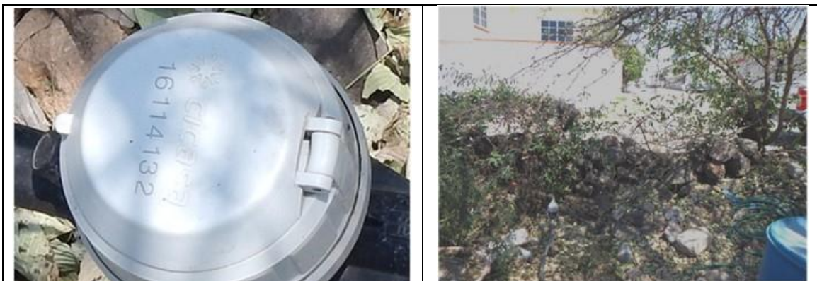
Figura 26. Medidor CICASA, MS Delaunet 16114132, clase B, sin VAF. Detalles de medidor con número de serie. Comunidad La Fuente, municipio de Tequisquiapan. Lectura del medidor: 282.10 m 3 . El medidor está instalado dentro del predio.
