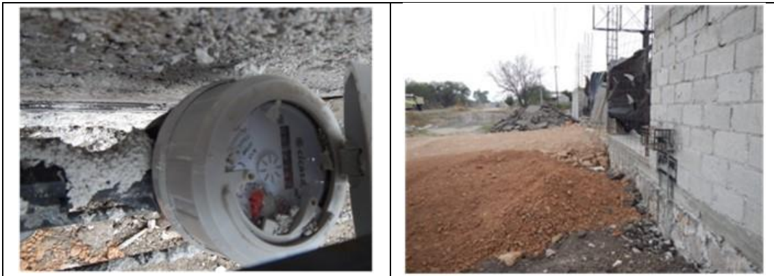
Figura 16. Medidor CICASA, MS Delaunet 17269331, clase B, sin VAF. Detalles de medidor con número de serie. Comunidad Fuentezuelas, municipio de Tequisquiapan. Lectura del medidor: 87.3 m 3 . El predio está en construcción.
