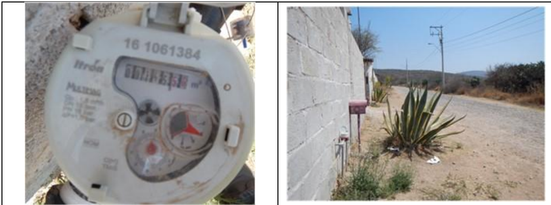
Figura 24. Medidor Itron, Multimag 161061384, clase C, con VAF. Detalles de medidor con número de serie. Comunidad La Fuente, municipio de Tequisquiapan. Lectura del medidor: 145.56 m 3 .
