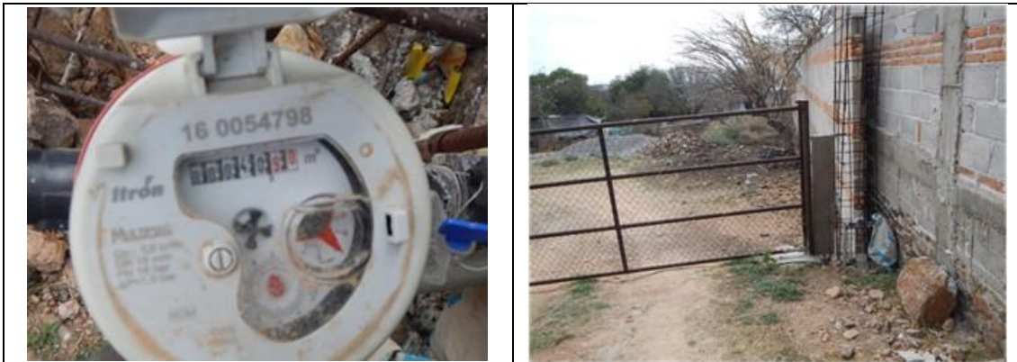
Figura 17. Medidor Itrón, Multimag 160054798, clase C, con VAF. Detalles de medidor con número de serie. Colonia Fuentezuelas, municipio de Tequisquiapan. Lectura del medidor: 40.90 m 3 .
