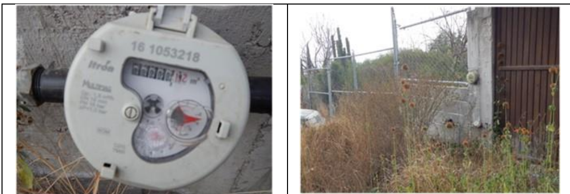
Figura 18. Medidor Itrón, Multimag 161053218, clase C, con VAF. Detalles de medidor con número de serie. Colonia Fuentezuelas, municipio de Tequisquiapan. Lectura del medidor: 0.12 m 3 . Casa deshabitada.
