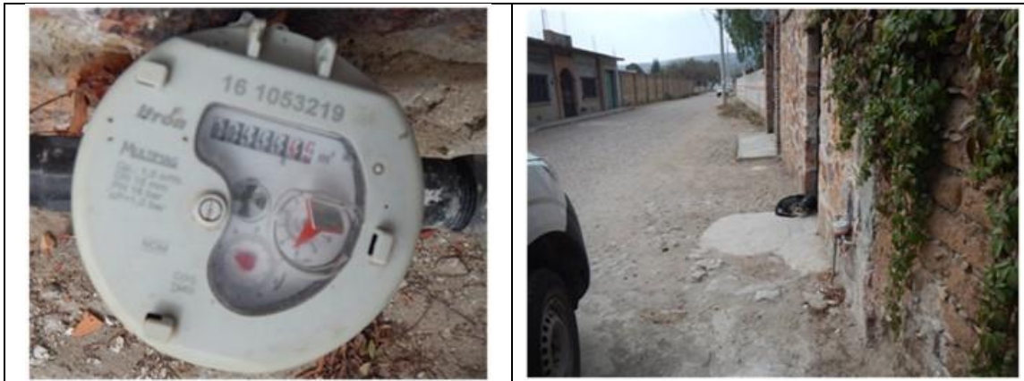
Figura 14. Medidor Itrón, Multimag 161053219, clase C, sin VAF. Detalles de medidor con número de serie. Comunidad Fuentezuelas, municipio de Tequisquiapan. Lectura del medidor: 444.42 m 3 . El medidor no tiene tapa.
