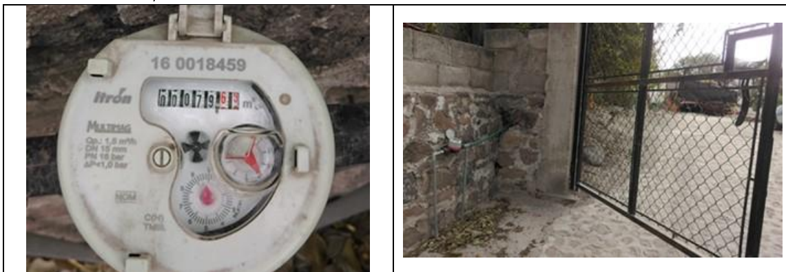
Figura 2. Medidor Itrón, Multimag 160018459, clase C, sin VAF. Detalles de medidor con número de serie. Barrio La Magdalena, municipio de Tequisquiapan. Lectura del medidor: 79.693 m 3 . El medidor está instalado en el interior del predio. Se encontró que debe corregirse la marca (es Itrón, no Itrón-Actaris) en el padrón de usuarios.
