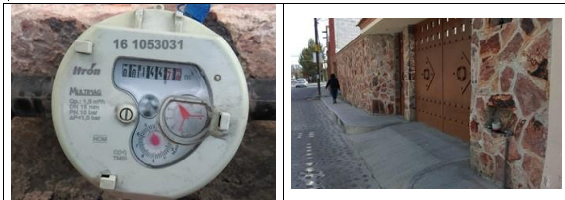
Figura 3. Medidor Itrón, Multimag 161053031, clase C, sin VAF. Detalles de medidor con número de serie. Barrio La Magdalena, municipio de Tequisquiapan. Lectura del medidor: 144.790 m 3 . El medidor no tiene tapa.
