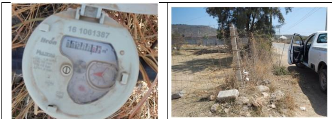
Figura 21. Medidor Itrón, Multimag 161061387, clase C, con VAF. Detalles de medidor con número de serie. Comunidad La Fuente, municipio de Tequisquiapan. Lectura del medidor: 211.81 m 3 .
