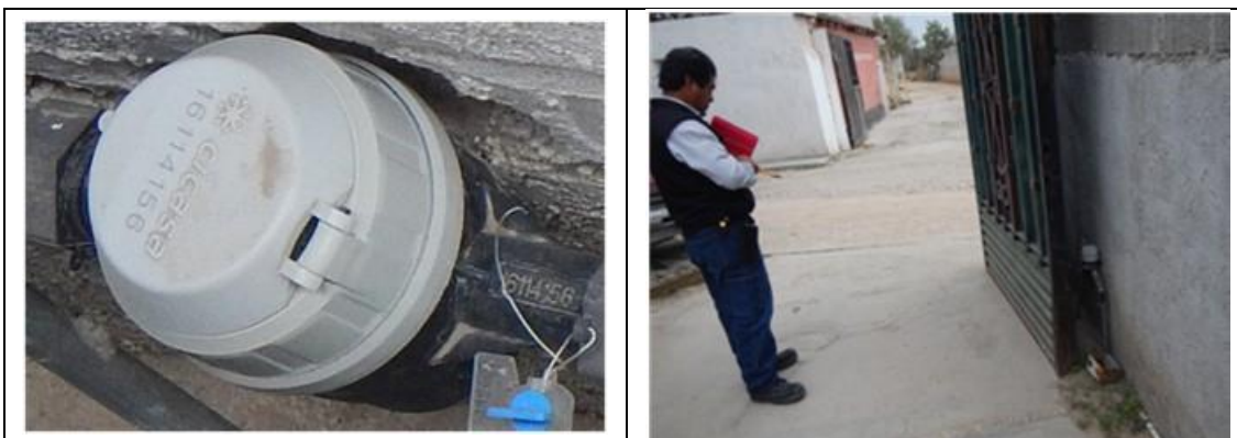
Figura 15. Medidor CICASA, MS Delaunet 16114156, clase B, sin VAF. Detalles de medidor con número de serie. Comunidad Fuentezuelas, municipio de Tequisquiapan. Lectura del medidor: 300.30 m 3 . El medidor está instalado en el interior del predio.
