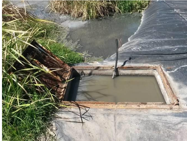
Figura 7. Cajas de distribución en mal estado, se observa la saturación de agua en el humedal.
