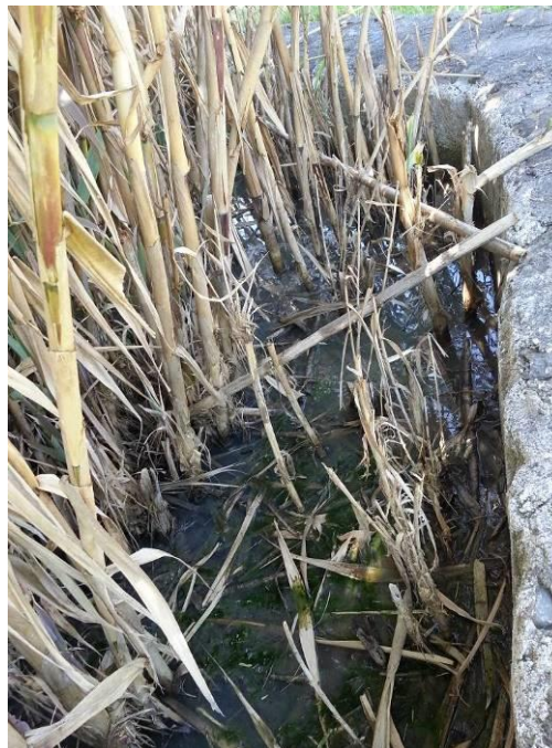
Figura 5. Celda de lodos colmatada.
