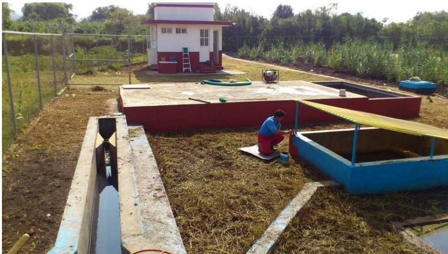
Figura 9. Celdas de lodos completamente llenas. .
