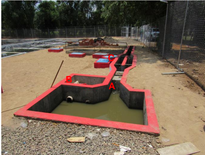
A) Tanque de amortiguamiento, B) tubería de excedencias, C) rejillas
