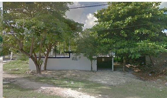
Ilustración 4.38 Cárcamo de agua residual No. 18
