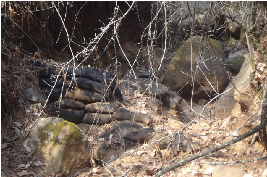
Figura 90. Presa de geocostales 02 donde se observan los daños en su estructura (27 de abril de 2017).
