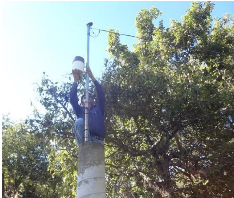
Figura 63. Mantenimiento de pluviómetros digitales en las microcuencas pareadas.
