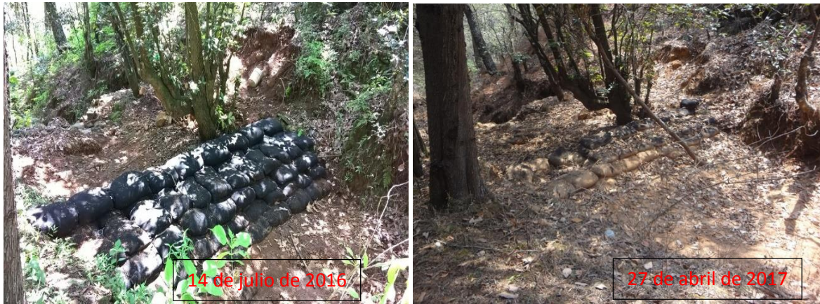
Figura 89. Presa de geocostales 01 donde se observa daños en su estructura y la retención de sedimentos después de 9 meses de construida.
