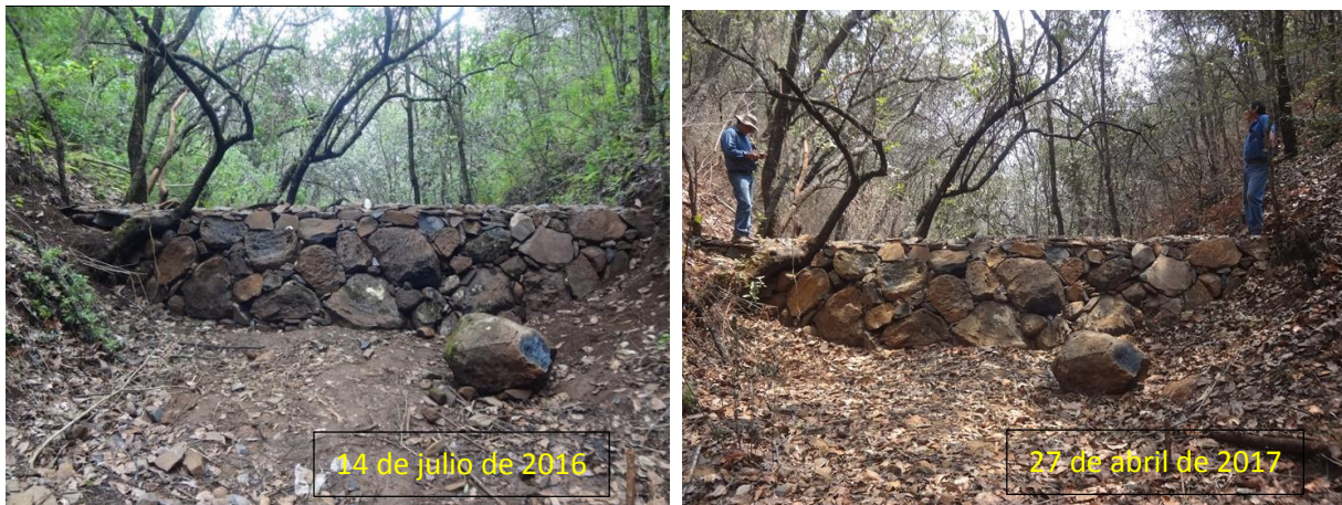
Figura 88. Presa de piedra acomodada 02 donde se observa la retención de sedimentos después de 9 meses de construida.
