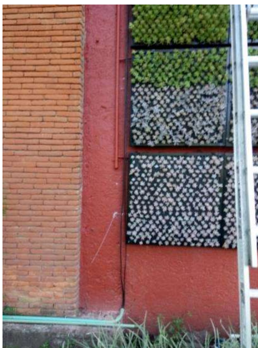
Figura 4.106 Conducción de los sistemas auxiliares, riego e iluminación
