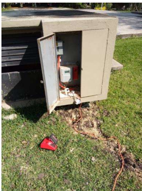
Figura 4.107 Toma eléctrica para el sistema de iluminación en tierra
