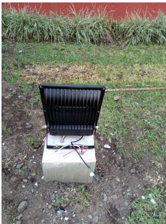
Figura 4.105 Sistema de iluminación en tierra
