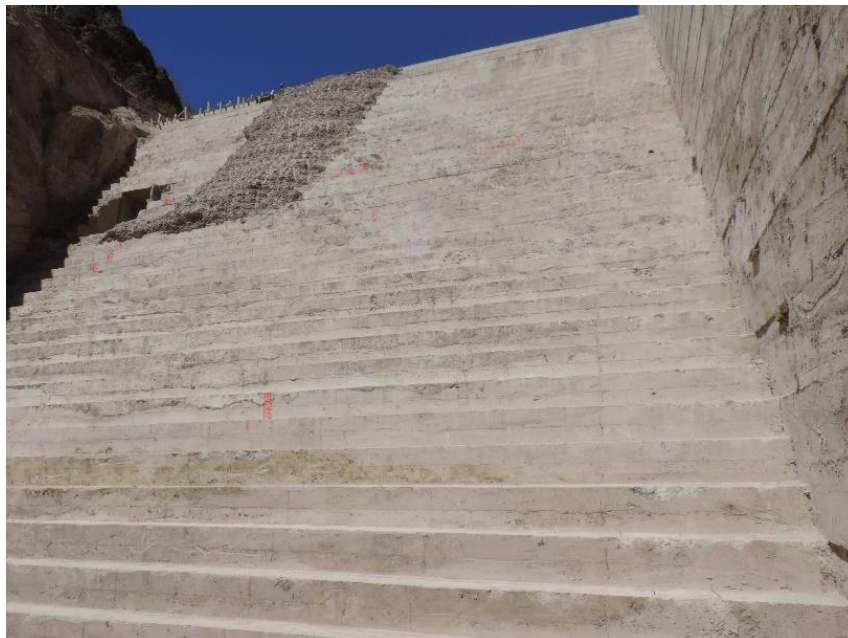
Figura 4-80. Vista general del monolito 6, donde el modelo numérico arrojó zonas de tensión.
