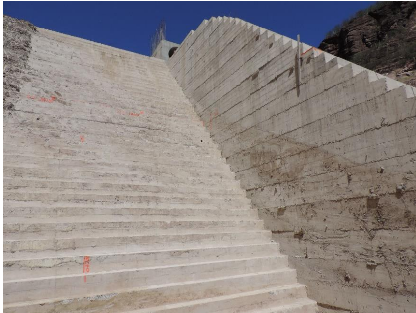
Figura 4-79. Zona de la cortina donde el modelo numérico arrojó esfuerzos de tensión que superan la resistencia.
