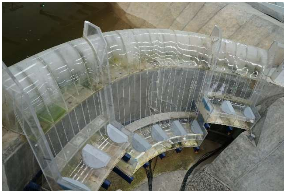
Fotografía. 107. Colocación de dados "D2" en la cubeta de los vertedores central y laterales.
