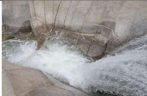
Fotografía. 93. Comportamiento hidráulico del flujo para un gasto de diseño 6010 m 3 /s
