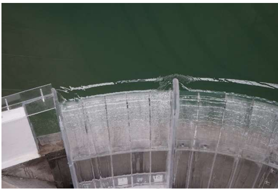
Fotografía 14. Se incrementan las contracciones del flujo en el muro de aproximación de la margen derecha. Q=3,730\text{m}^3/\text{s} .
