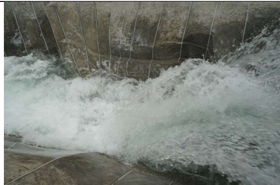
Fotografía 117. Alcance del chorro para la configuración original. Sin ataguía. La ventana 1 y su camino de acceso reciben salpicaduras considerables.
