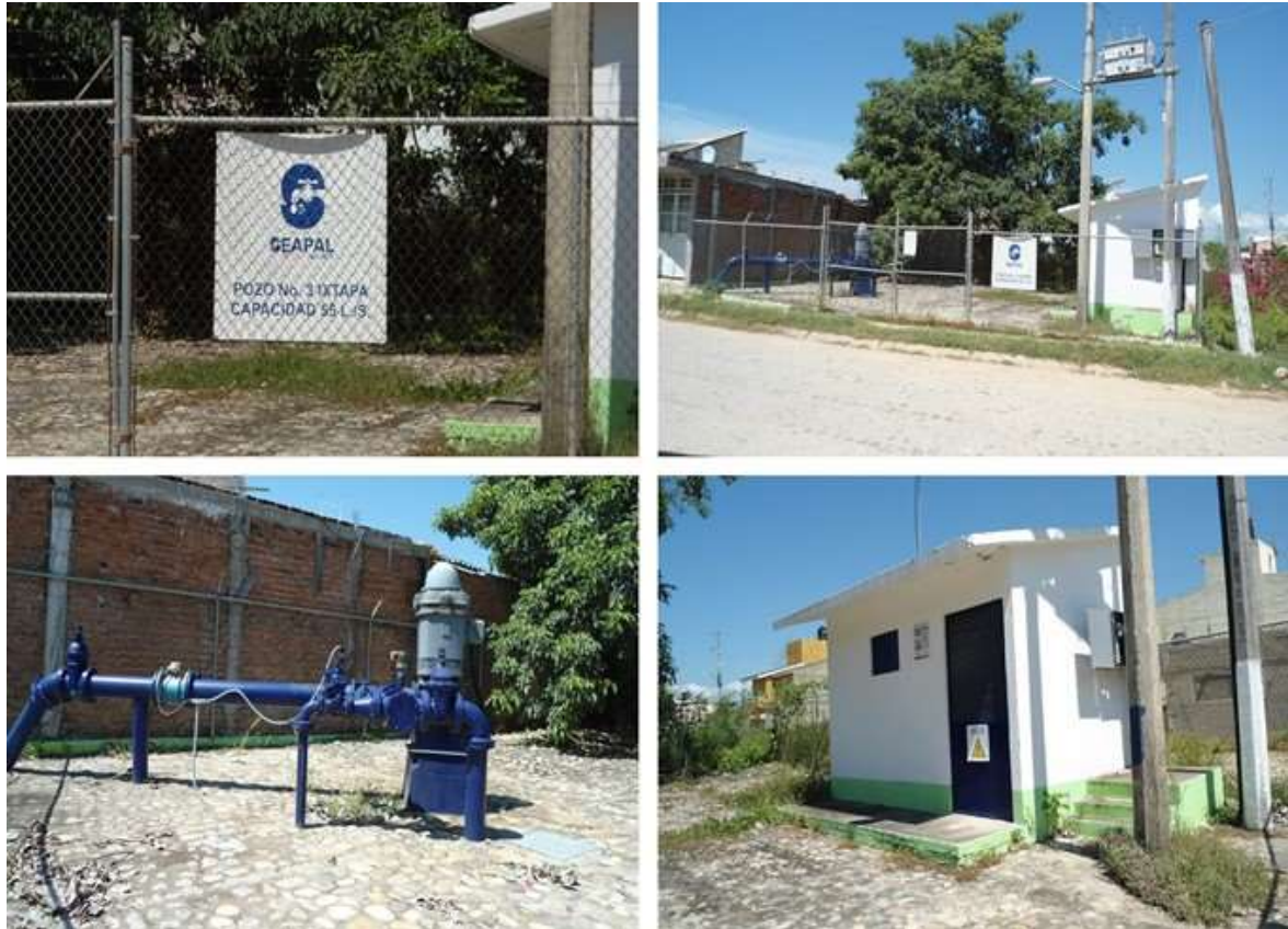
Ilustración 3. Infraestructura en el pozo No. 3 Ixtapa.
