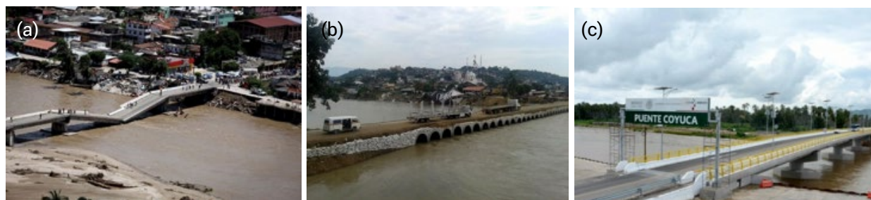
Figura 12.6. Puente Coyuca, estado de Guerrero: a) Colapso del puente, b) Puente provisional construido 15 días después del colapso, c) Nuevo puente Coyuca construido un año y dos meses después. Fuente: www.eluniversal.com.mx
