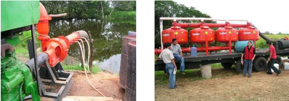
Figura 9.2 Fuente de abastecimiento de agua superficial para riego y sistema de filtrado de grava y arena
