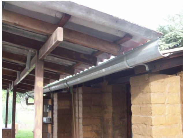
Figura 2.7 Vista de una canaleta circular en techo de lámina
