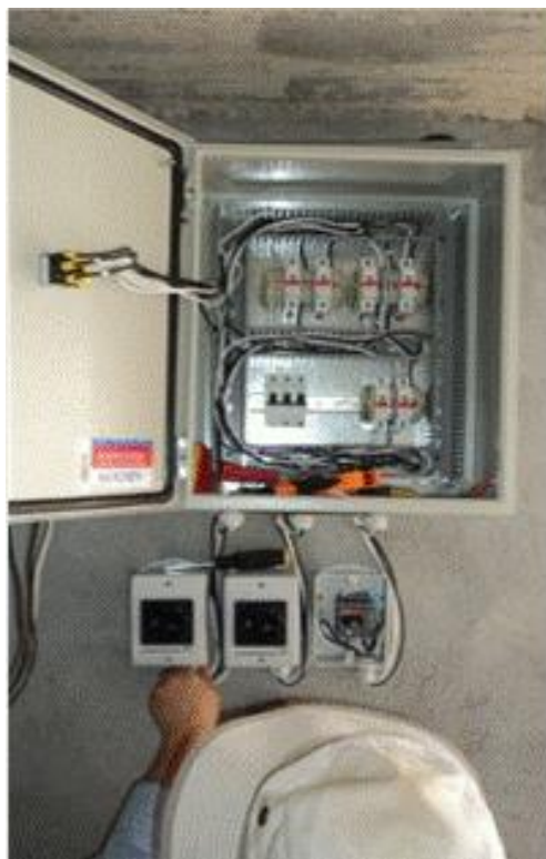
Figura 3.27 Gabinete de control del cárcamo de bombeo
