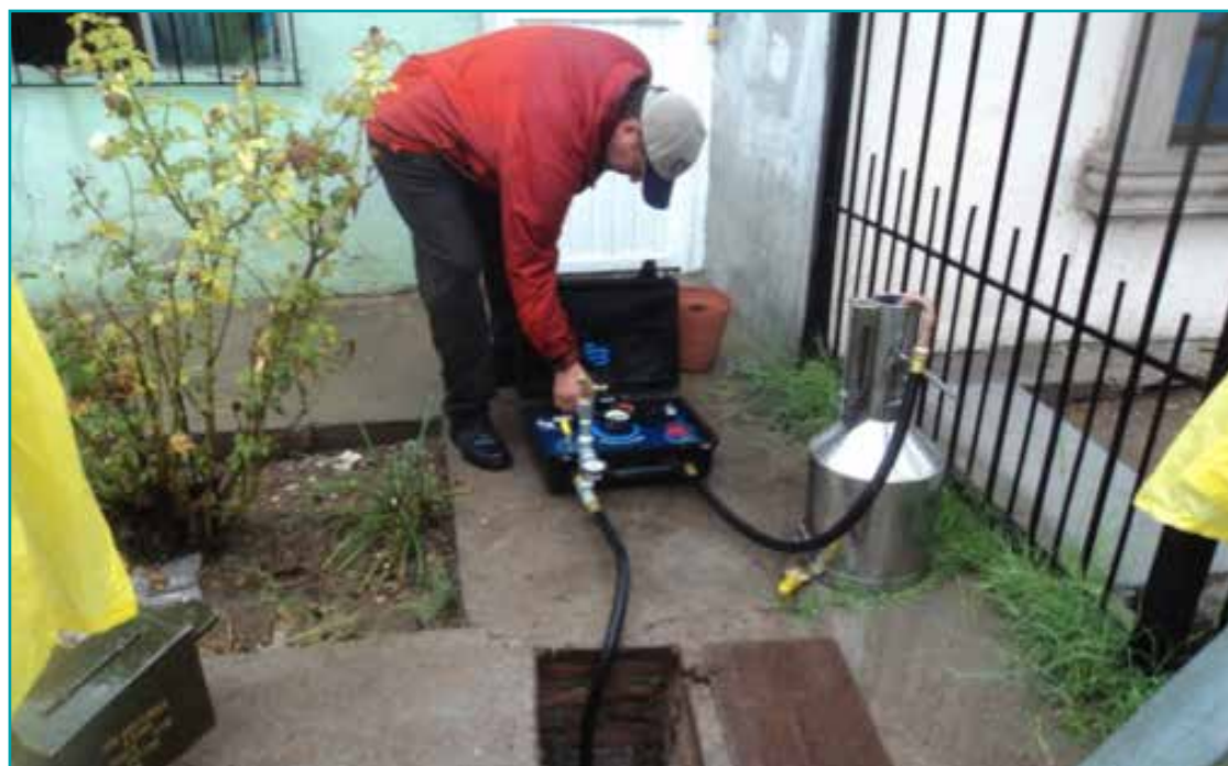
Figura 6.2. Evaluación del rendimiento de medidores en sitio.
