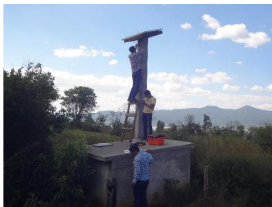
Figura 4.15 Revisión del funcionamiento de los paneles solares que proporcionan energía a los equipos medidores
