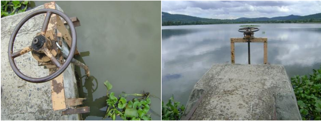
Figura 5.44 Compuerta de toma
