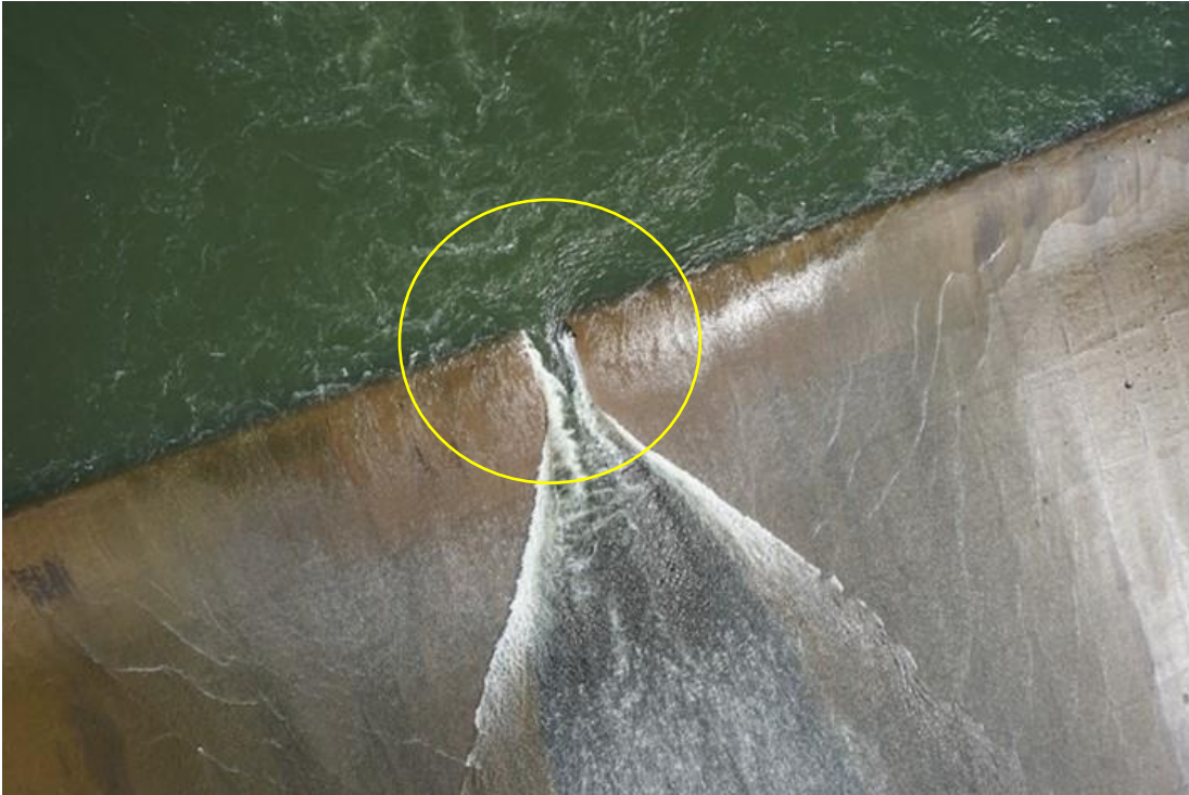
Figura 5.48 Detalle del desgaste del vertedor en la zona de convergencia de flujos
