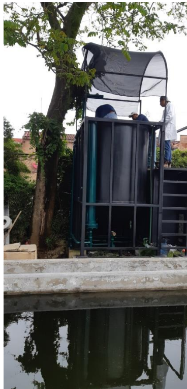
Figura 4.7. Mantenimiento y puesta en marcha del prototipo instalado en el TEXCAL.
