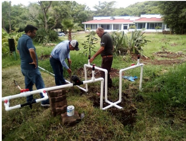
Ilustración 14 Armado de sistema de riego con fertirriego
