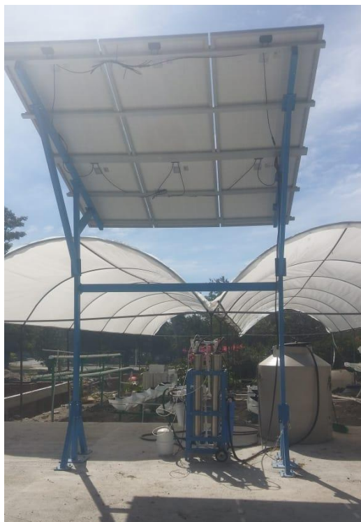
Ilustración 53 Unidad de Nanofiltración.
