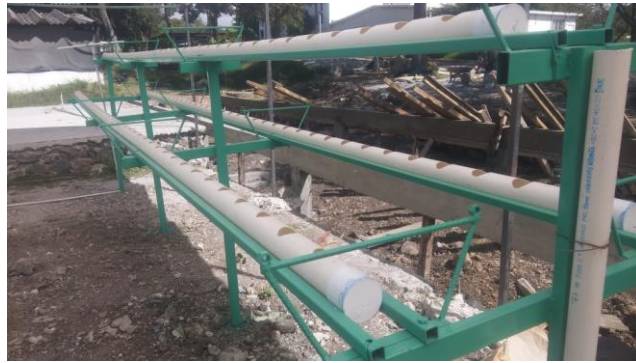
Ilustración 59 Estructura para riego hidropónico
