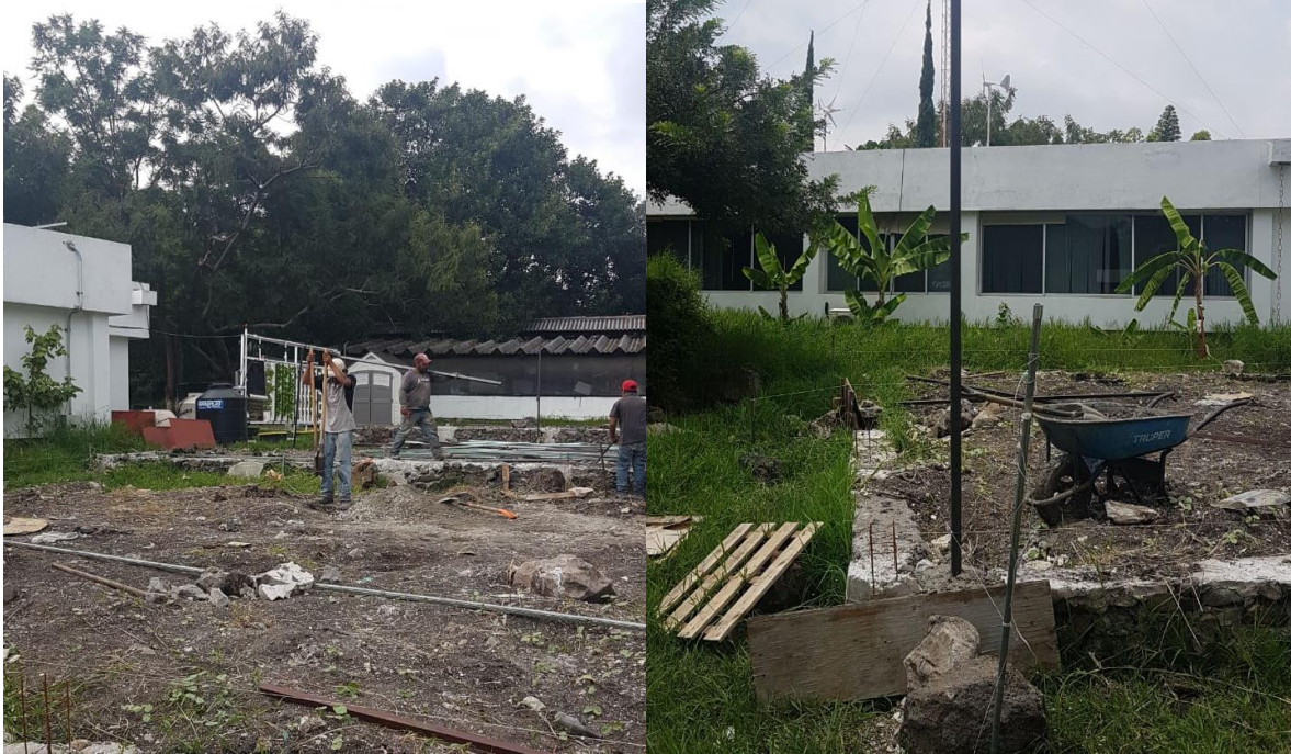
Ilustración 22. Trazo y Excavación de pozos para instalación de tubos para arco techo.
