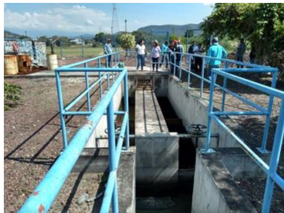
Foto 4.53 Recorrido por la PTAR
