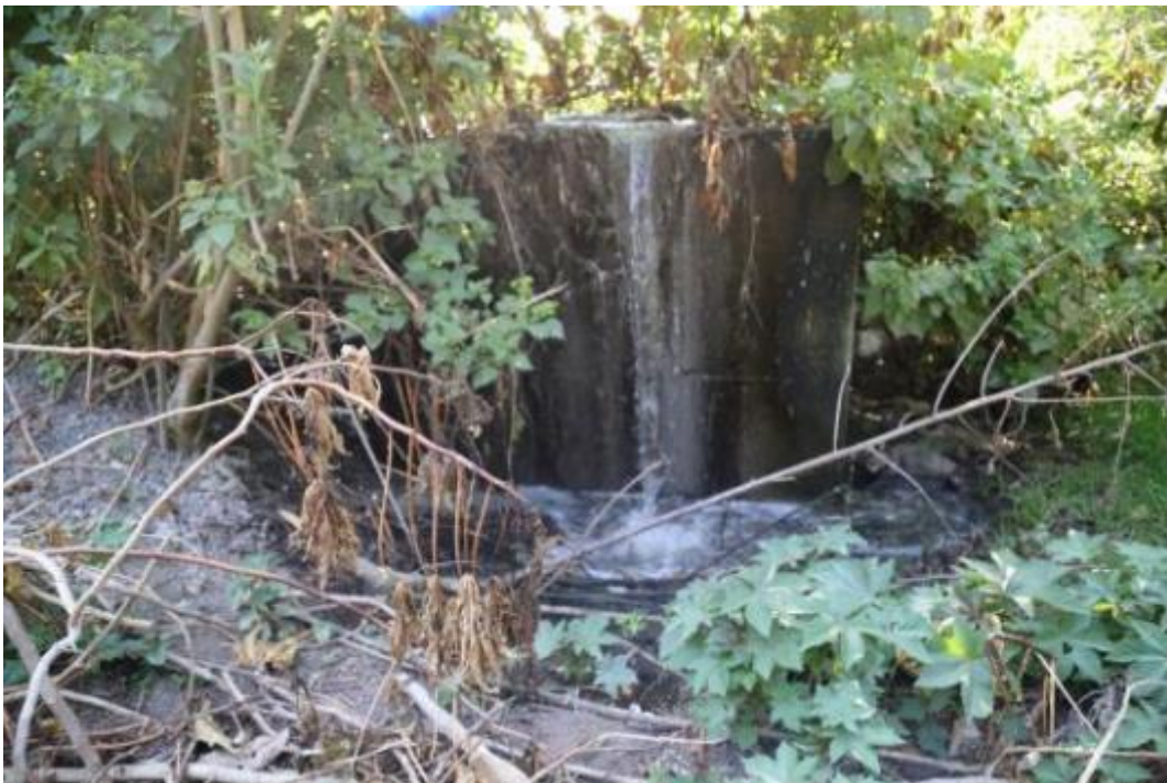
Foto 5.2.27.- Segundo módulo de la PTAR. Punto donde se derrama prácticamente el 100% del agua residual sin completar el ciclo de tratamiento y se canaliza al río Amanalco.
