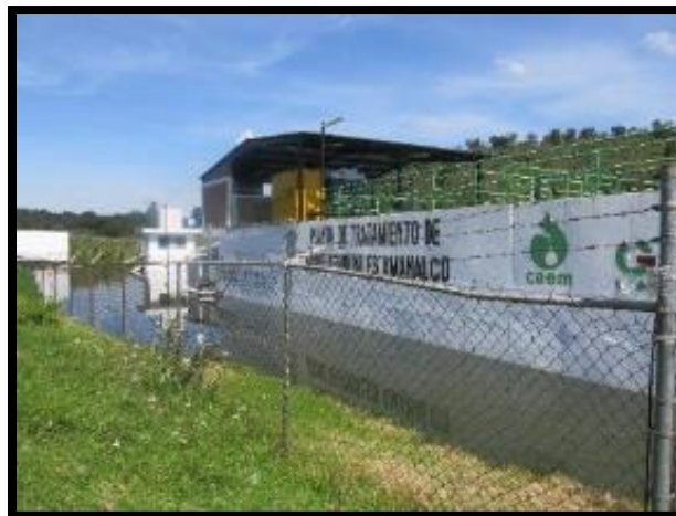
Foto 5.1.4.16.- Planta de tratamiento de San Juan inundada.
