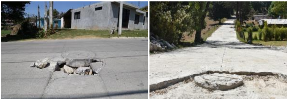
Fotos 5.4.1 y 5.4.2- Calles de San Mateo con pavimento dañado por las obras de drenaje.
