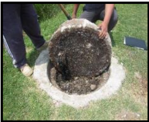
Foto 5.1.4.14.- Aguas residuales y azolve retenido en los pozos de visita del colector marginal de Amanalco.
