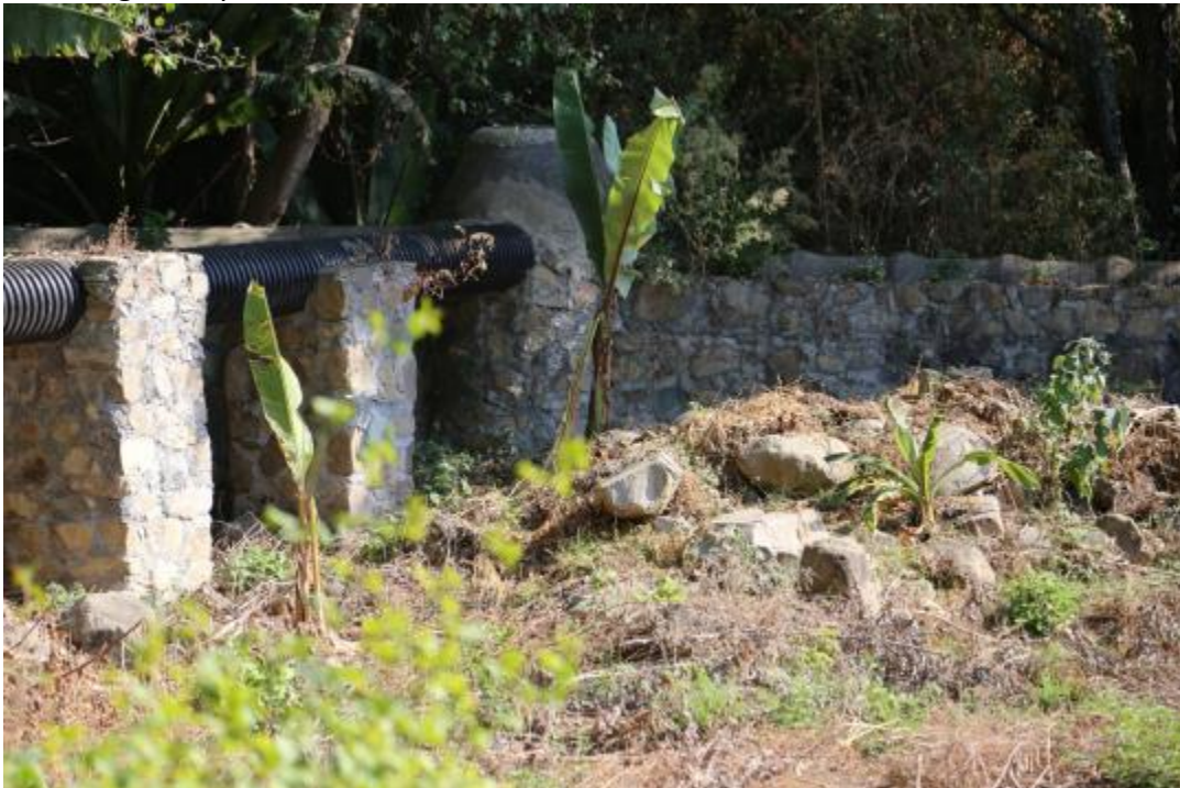
Foto 5.2.25.- Fotografía del colector de alcantarillado de San Francisco Mihualtepec antes de llegar a la planta de tratamiento
