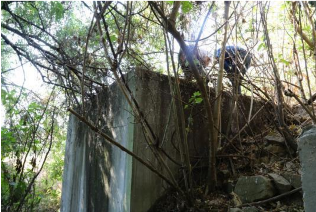
Foto 5.2.28.- Cuarto y último módulo de la planta de tratamiento. A este módulo sólo llegan algunas gotas de agua.
