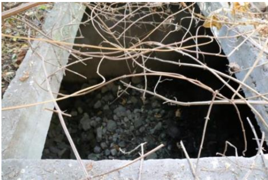
Foto 5.2.29.- Interior del último módulo de la PTAR de San Francisco.
