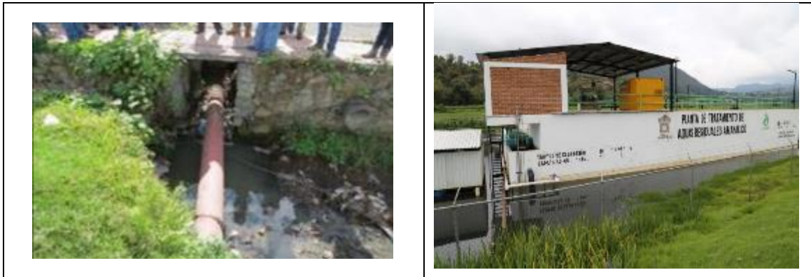
Fotos 1 y 2. Aspectos de la infraestructura de drenaje de las localidades de Amanalco.
