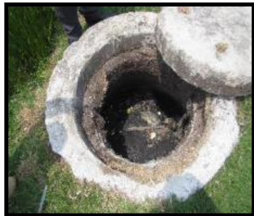
Foto 5.1.4.13.- Aguas residuales y azolve retenido en los pozos de visita del colector marginal de Amanalco.
