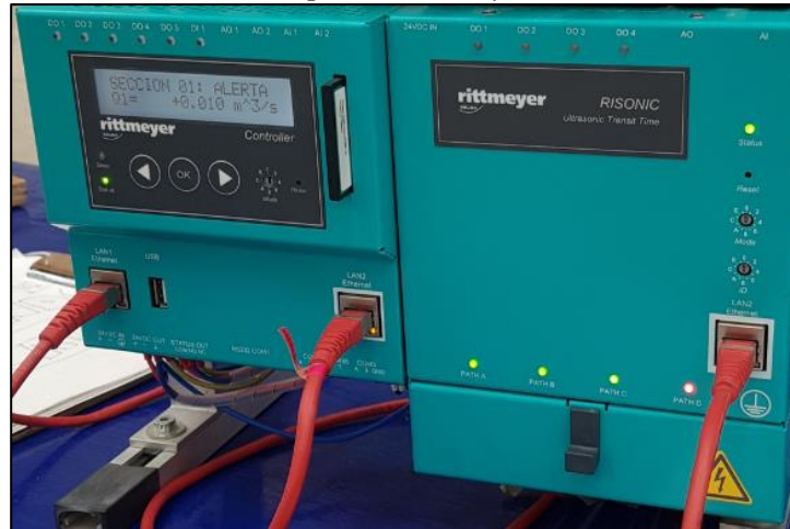
Ilustración 11: Pantalla del módulo controlador del equipo ATT. Rittmeyer.
