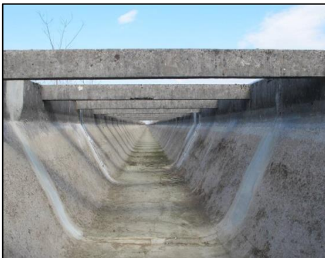
Ilustración 85: Vista transversal de un canal trapezoidal de campo en donde se encuentra instalado un sistema multi par de transductores Tiempo de Travesía.
