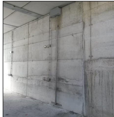
Ilustración 88: Instalación de un sistema multi par de transductores Tiempo de Travesía en un canal rectangular en campo.
