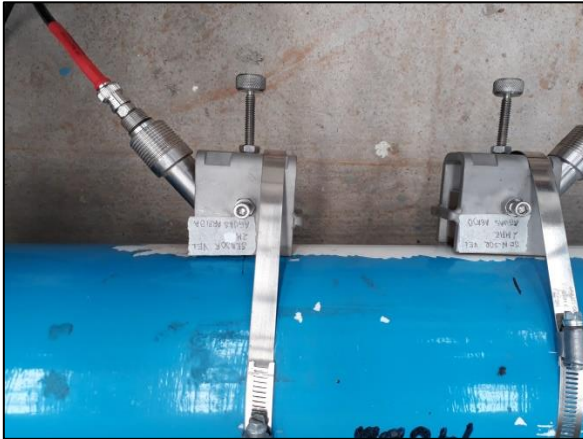
Ilustración 54: Un par de transductores ultrasónicos, no intrusivos, tiempo de travesía, instalados en una tubería de acero de 20” (1MHz).
