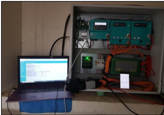
Ilustración 79: Fotografía del momento de la medición del gasto con un escenario en donde fallan cinco pares de sensores de velocidad. El celular tiene corriendo un temporizador y la computadora se encuentra descargando la información en tiempo real.
