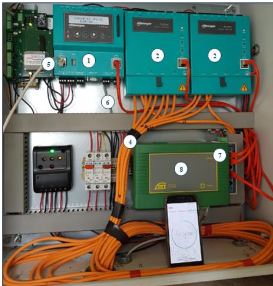
Ilustración 4: Equipo ATT instalado en el canal Humaya.
