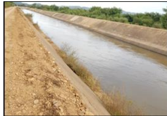
Ilustración 81: Canal Humaya, km 5+ 000.
