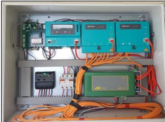
Ilustración 78: Sistema automático de medición Tiempo de Travesía con 6 pares de transductores (dos moduladores), todo el conjunto dentro de un gabinete de una estación.
