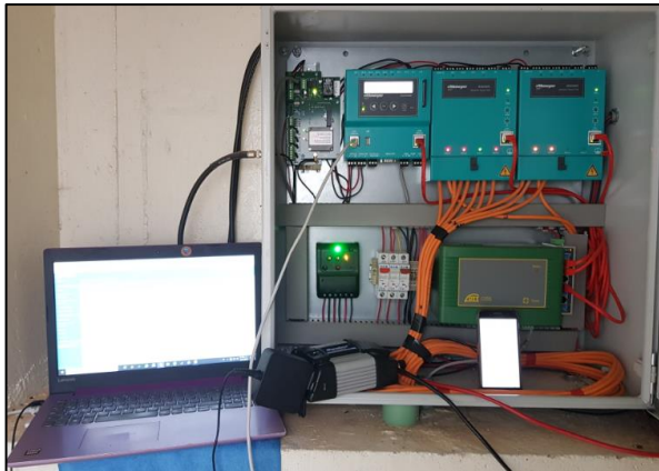
Ilustración 27: Equipo ATT de la caseta de medición del canal Humaya.
