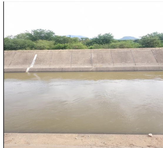
Ilustración 82: Gasto de 60 m 3 /s pasando en el Canal Humaya, km 5+ 000.
