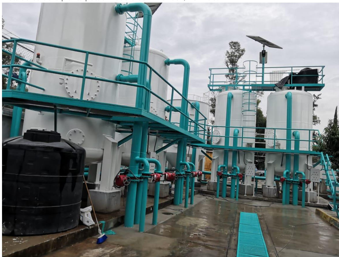
Planta potabilizadora "la Viga 4" Jennifer Bañuelos.
