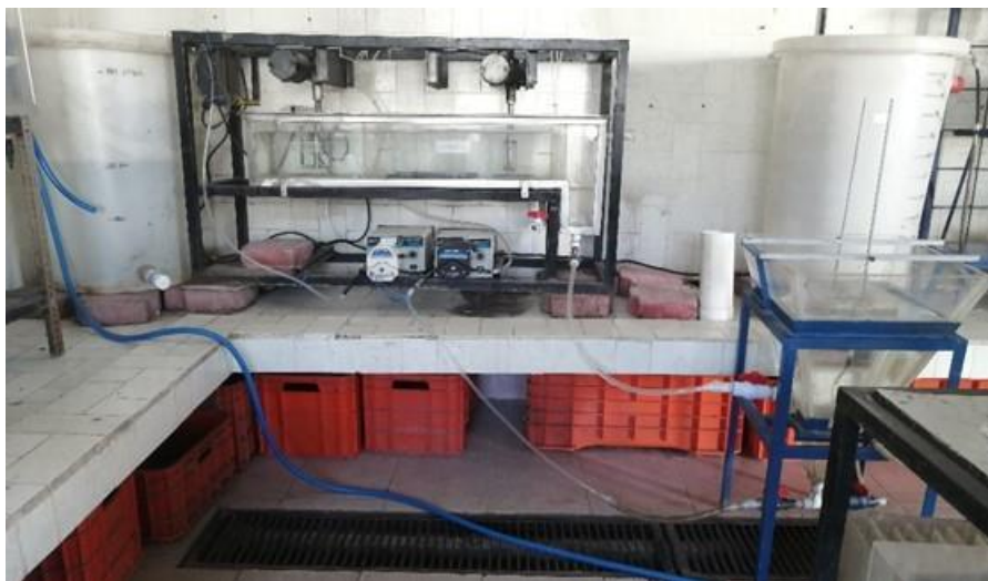
Figura 9-2. Pruebas hidráulicas y operación de bombas peristálticas
