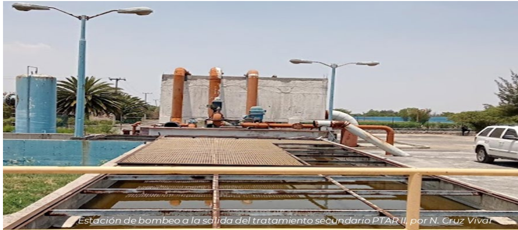
Figura 3-100. Estación e bombeo a la salida del tratamiento secundario PTAR II.
