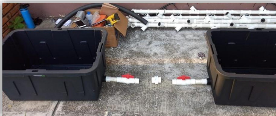
Figura 4.32 Captación de la solución nutritiva para recirculación
