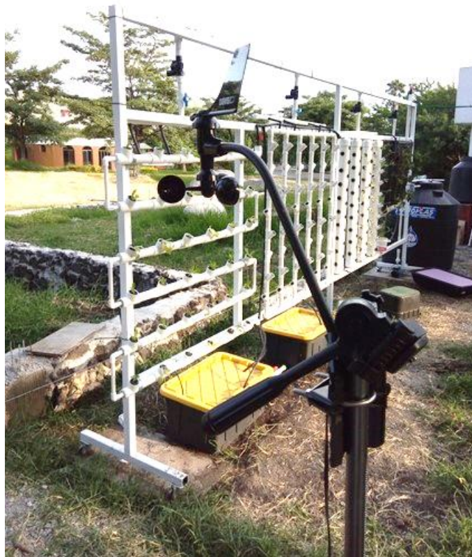
Figura 4.35 Disposición de sistema de riego solar, eléctrico y estación meteorológica instaladas
