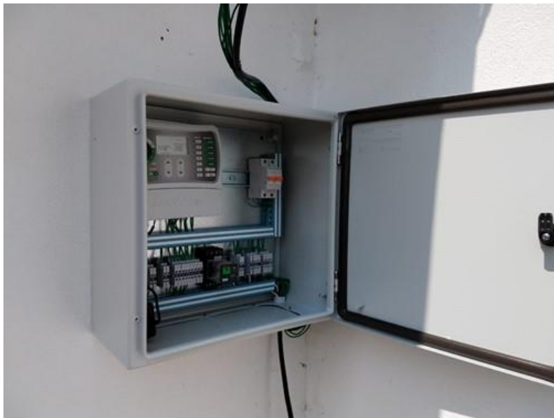
Figura 4.34 Panel de control para programación del riego
