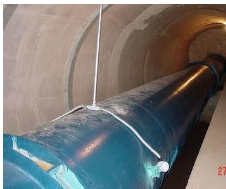
Foto 5 ATT de un par externo Presa Las Lajas (CONAGUA, 2003)
