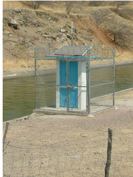
Caseta de operación de un ADL
