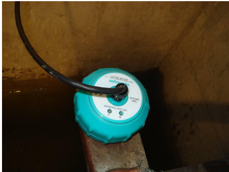
Fig. 4. Sensor de nivel y pozo de amortiguamiento ubicados dentro de la caseta de operación
