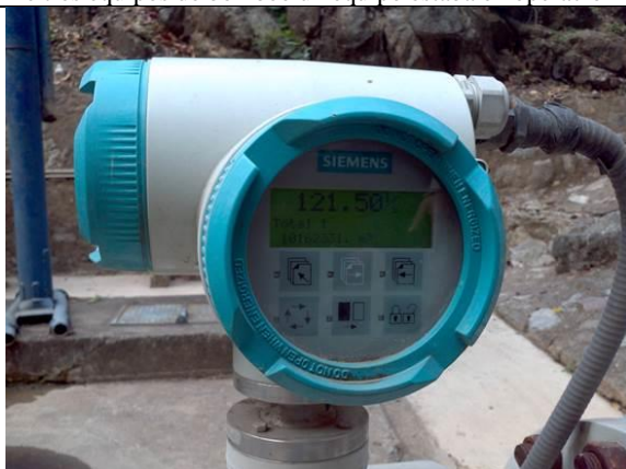
Registro del gasto a enviar al siguiente rebombeo 121.5 l/s
