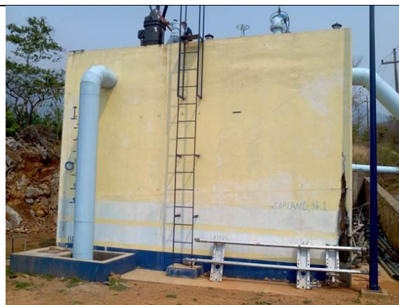
Control de niveles en el tanque
