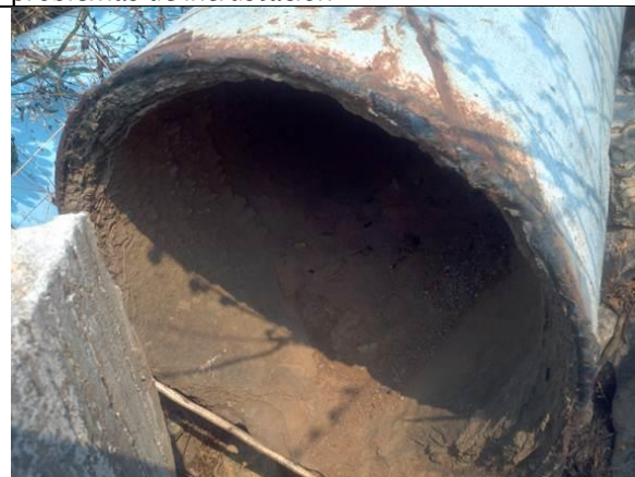
Incrustación de un espesor de 3 cm.
