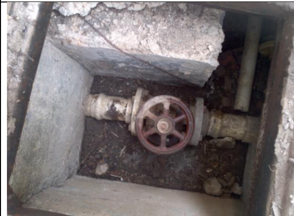
Faltó interconectar a la nueva línea
