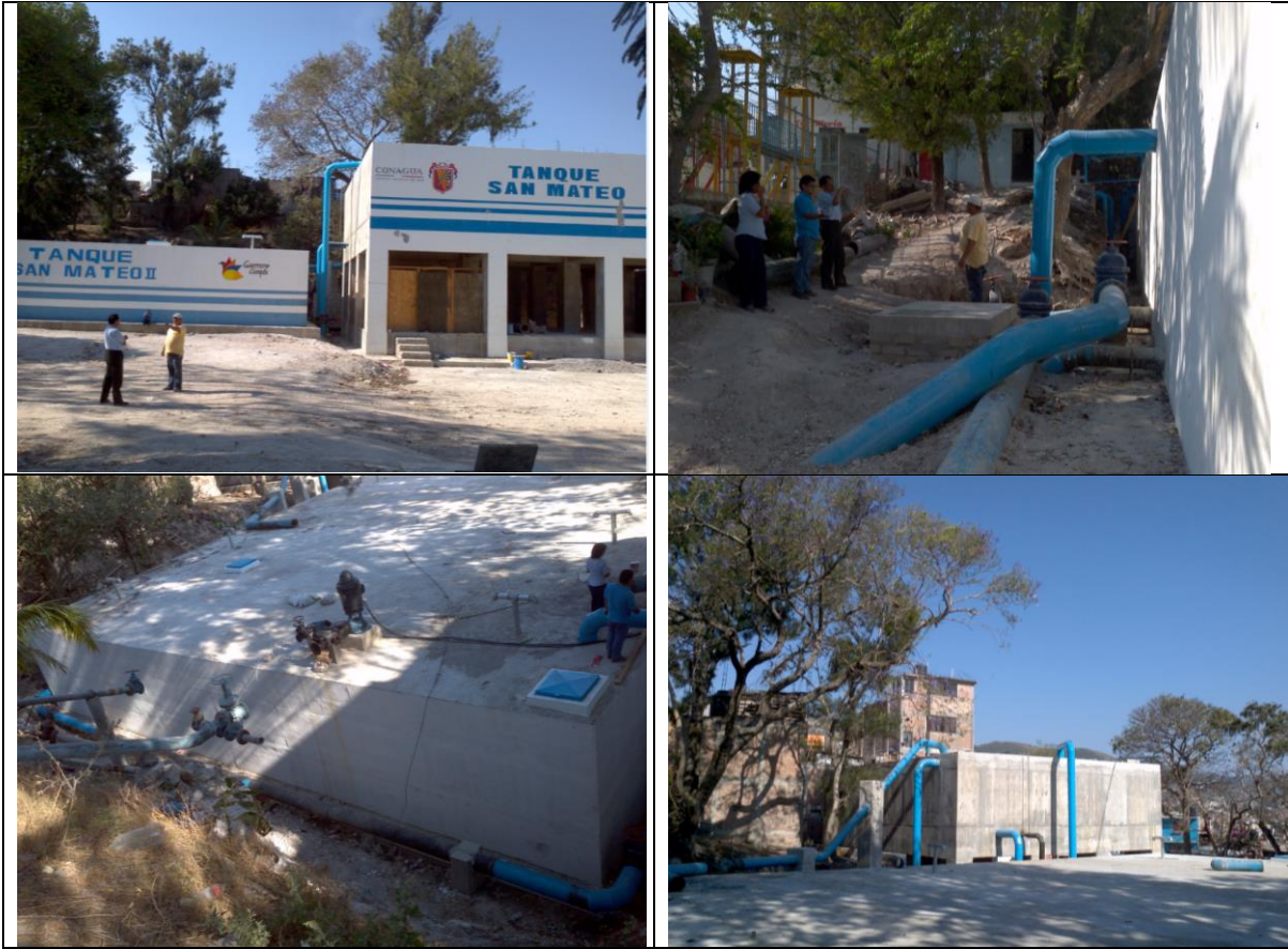
Tanque maestro San Mateo, nuevo, tuberías por todos lados, y no tienen agua las colonias que abastece.
