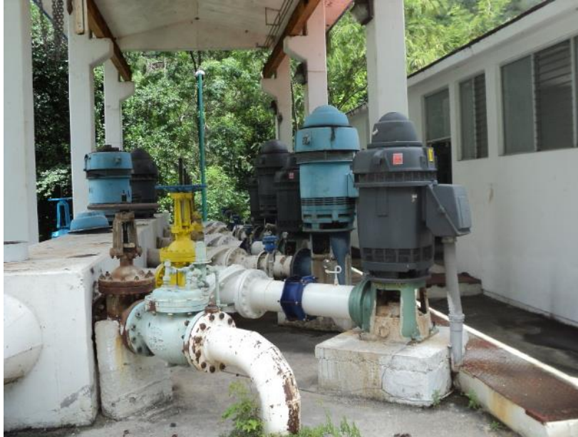
Ilustración 1.59. Equipos de bombeo, de los cuatro solo uno está operando
