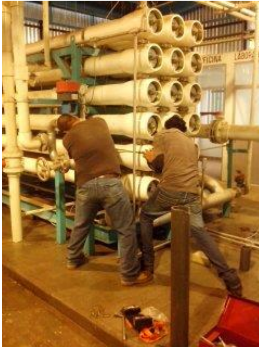
Ilustración 2.3. Colocación de las membranas en la vasija de presión #3 utilizando un tensor de matraca
