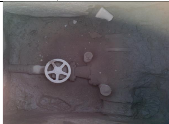
Reducción de tubería
