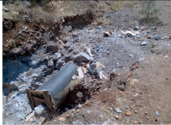
Sitio Salto de Valdez no están terminados los trabajos de interconexión para que opere la nueva línea de Acahuizotla
