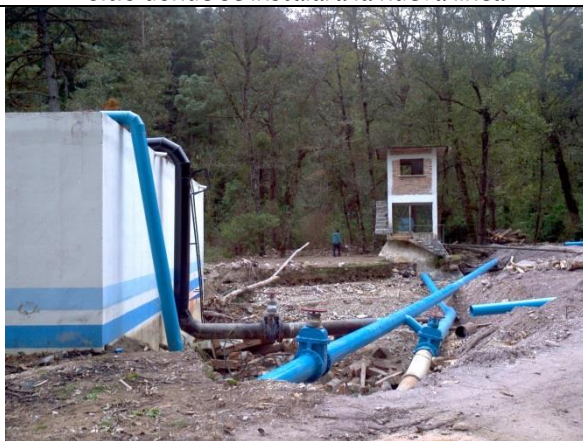
Sitio donde se conectará para el llenado del tanque
