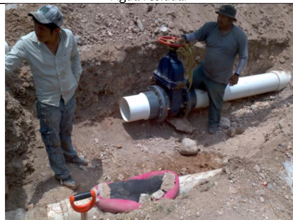
Falta conectar línea
