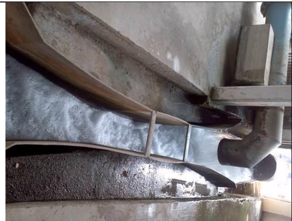
El Parshall con las dos descargas simultáneas, mucha turbulencia, solamente sirve de conducción
