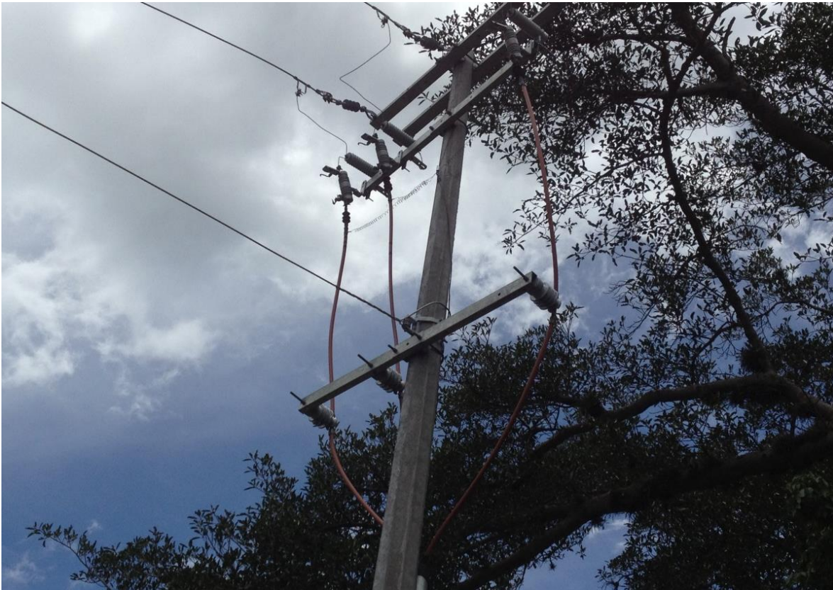
Ilustración 2.5. Poste de alimentación sin el fusible respectivo
