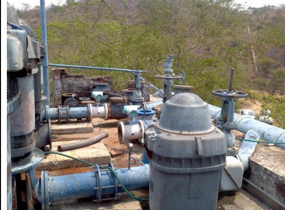
Falta de mantenimiento preventivo y correctivo
