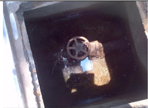
Caja de válvulas inundada con raíces
