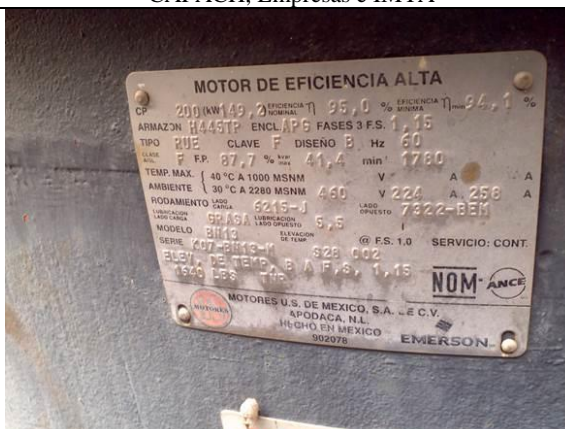
Placa con las características del equipo de bombeo
