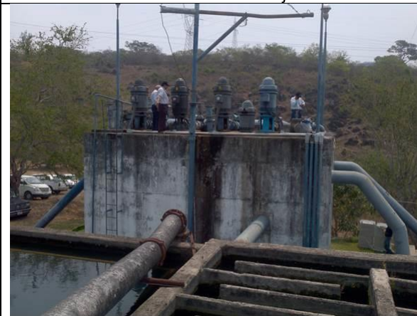
La planta dispone de 4 equipos. 2 ya cumplieron su vida útil y dos nuevos, uno se está instalado y otro está empaquetado.
