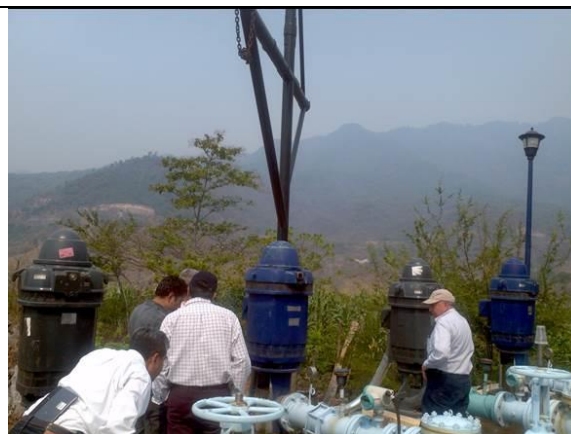
Personal de: CONAGUA, Empresas e IMTA, revisando equipos de bombeo y medidores s/func.
