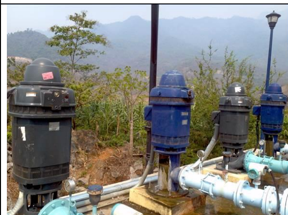
Se disponen de 4 equipos de bombeo. Solamente dos equipos están operando, requieren mantenimiento.
