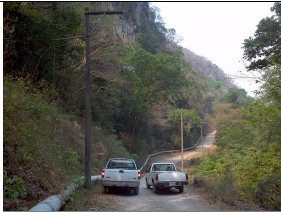
Línea para abastecer Cárcamo # 1
