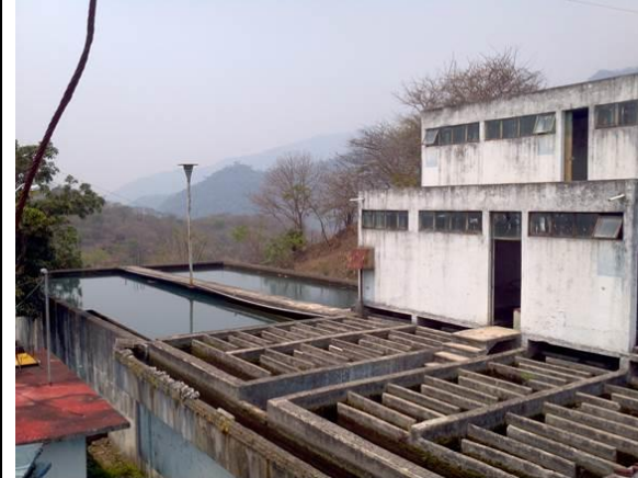
Instalaciones en general falta mantenimiento
