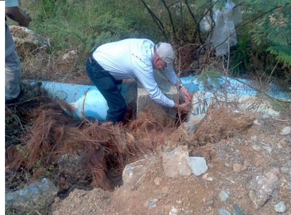
Personal de la CONAGUA inspeccionando problemas de incrustación
