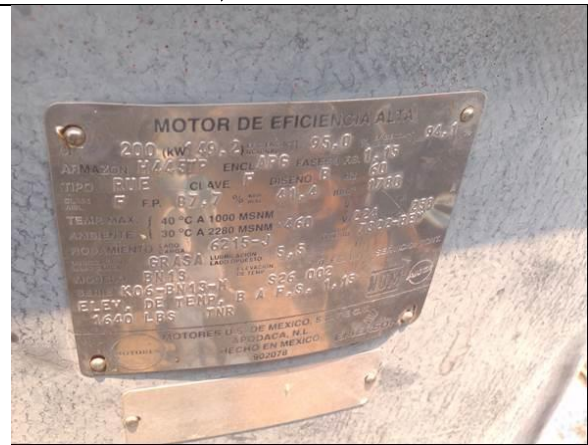
Características de los equipos de bombeo viejos
