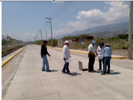
En esta calle no existían cajas de válvulas
