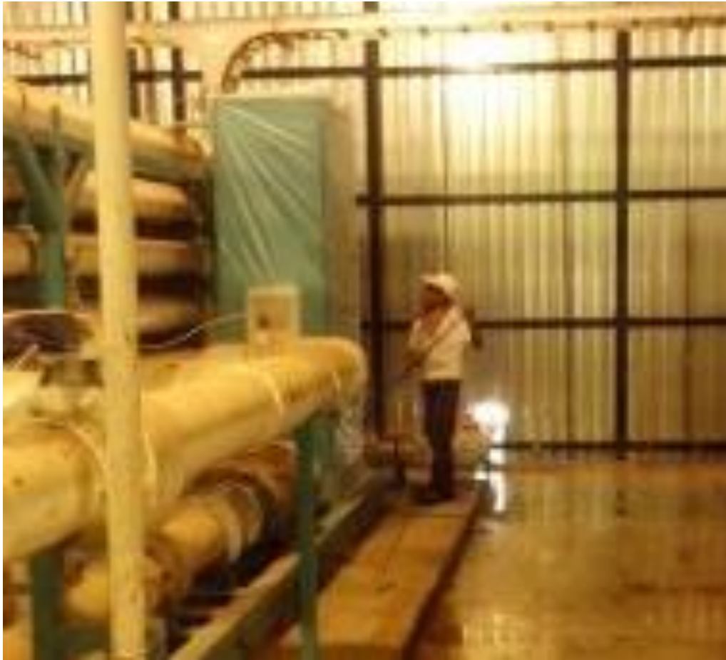
Ilustración 2.9. Gabinete recubierto con película plástica para su protección
