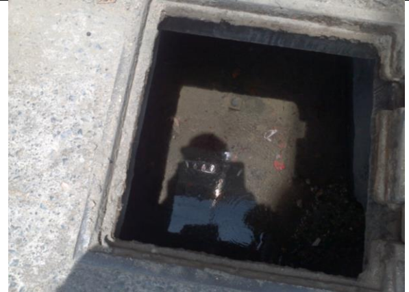
Válvula con fuga
