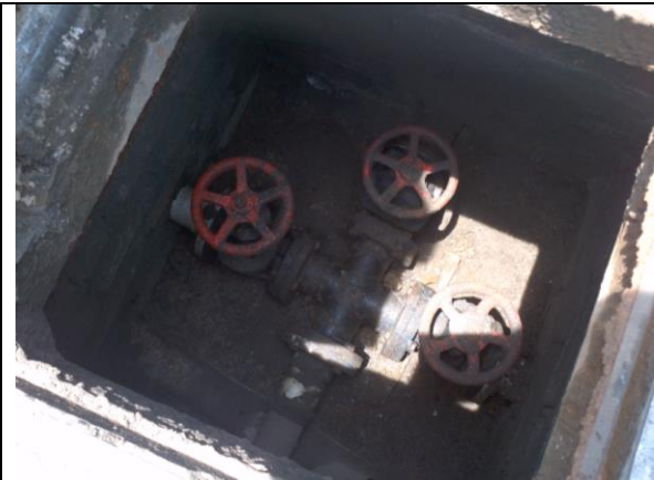
Caja de válvulas sustituidas
