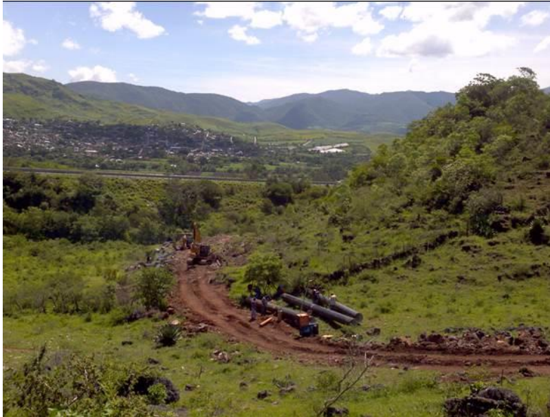
Ilustración 1.54. Continuación de los trabajos de instalación en las cercanías a la autopista
