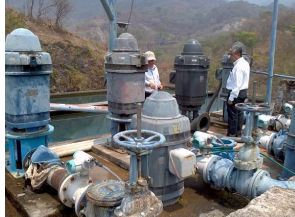
Los medidores no están funcionando.
