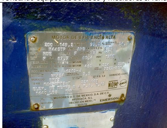
Placa con las características de los equipos de bombeo
