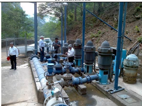
De tres equipos de bombeo un equipo estaba en operación
