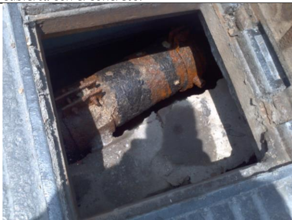
Tubería con posible problema de incrustación
