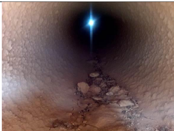
Incrustación en el interior de la tubería de acero
