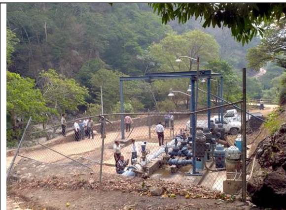
Por la margen derecha del río se ubica la Planta de bombeo de Acahuzotla
