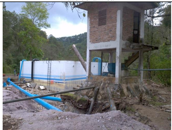
No existe una descripción en el informe de estas instalaciones
