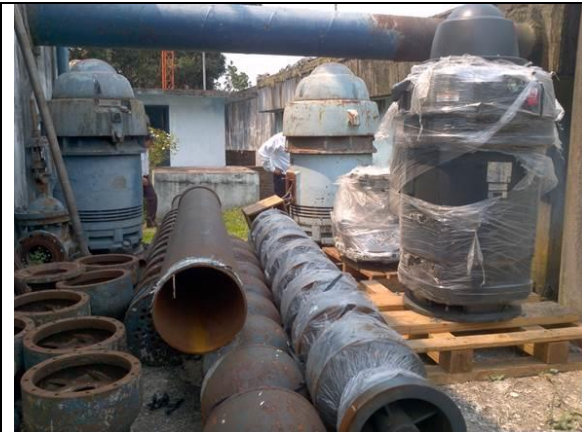
Equipo de bombeo nuevo por instalar
