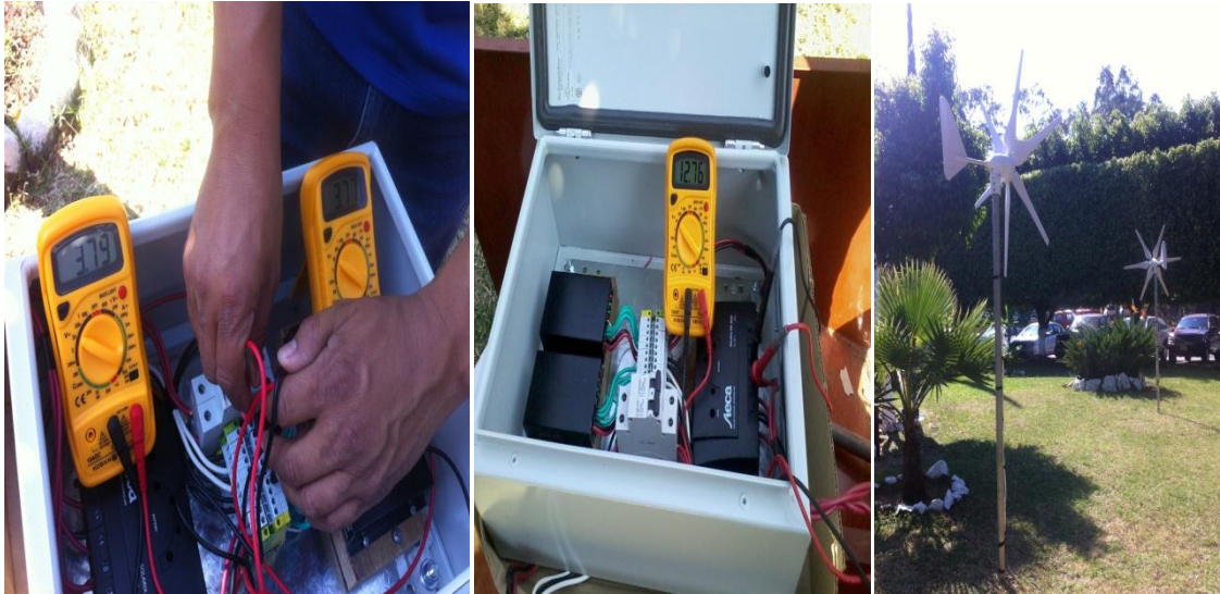
Monitoreo de voltajes de los aerogeneradores eólicos de 300 Watts a 12 VCD.
