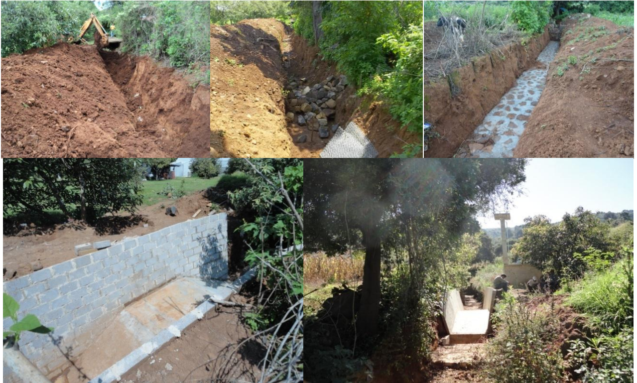
Figura 36. Serie de trabajos para la construcción del vertedor en la microcuenca Ichupio.
