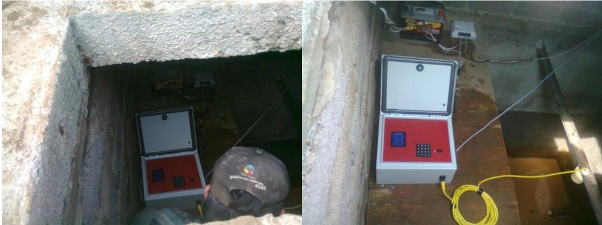
Figura 40. Sensores ultrasónicos instalados en las microcuencas Ichupio y Malacate.
